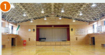
1 小中学校体育館の空調設備
